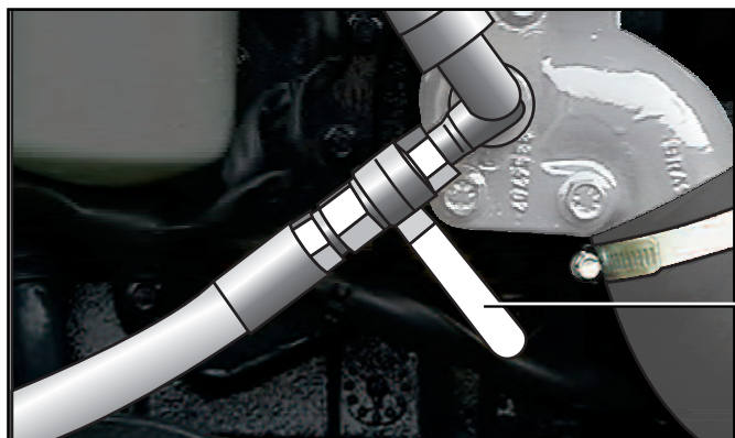
Llave de Paso Agua Caliente Cerrado
